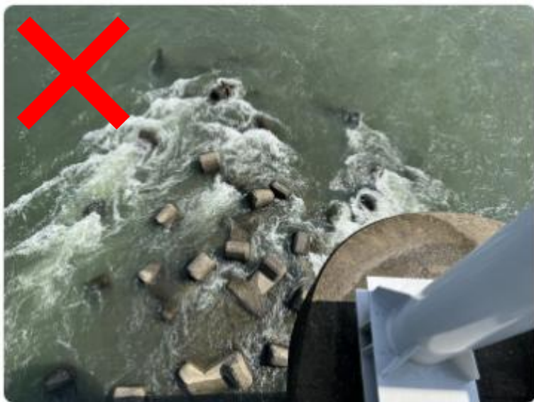
洗掘箇所は近接が困難
